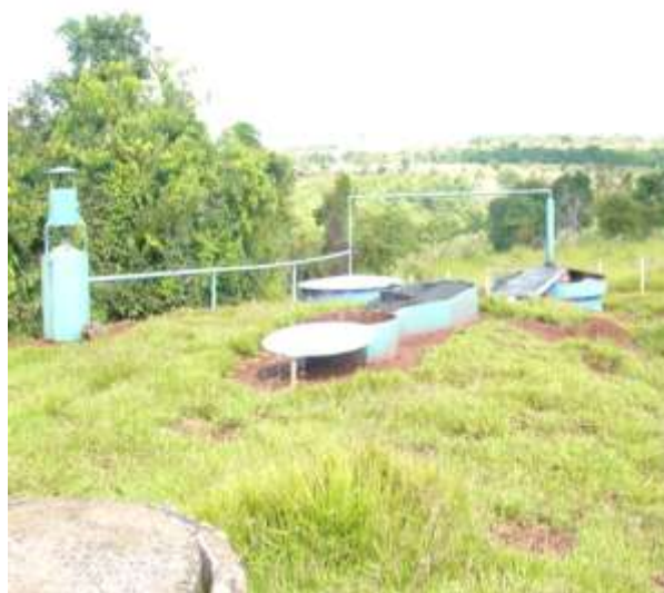
Figura 41 - Estação de Tratamento de Esgoto de Martinésia, março de 2009. Foto: João Carlos de Oliveira.
