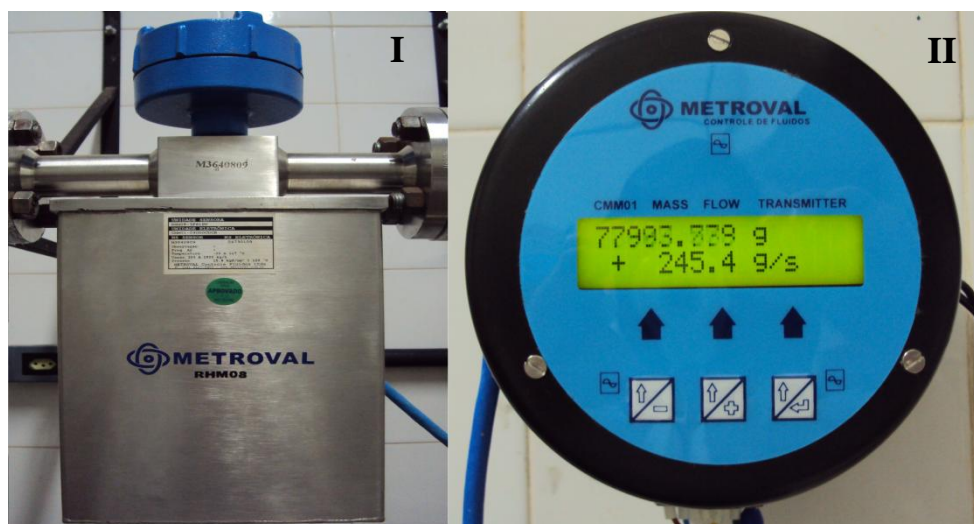
Figura 3.3 – Medidor de vazão tipo Coriolis instalado na unidade de hidrociclonação – (I) sensor e (II) totalizador.
