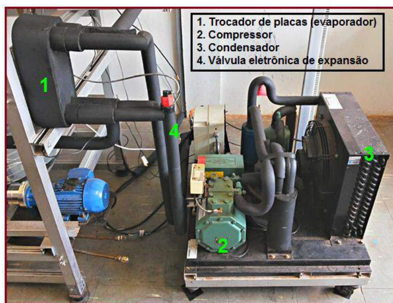
Figura 3.11 - Sistema de refrigeração
