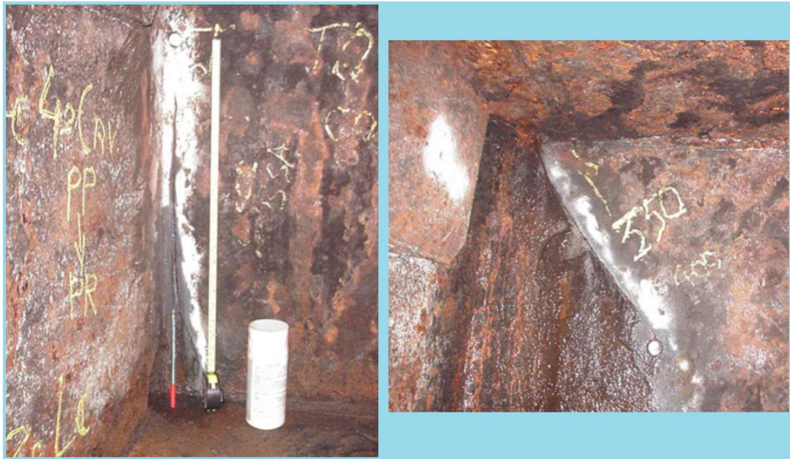
Figura 1.1 – Trincas em tanques de armazenamento de um FPSO da PETROBRAS (SOUZA, 2006)
