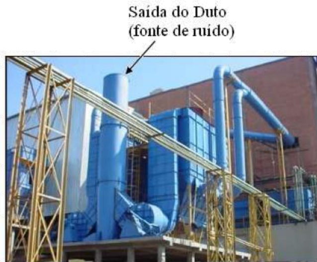
Figura 1.1 – Duto de ventilação industrial.
