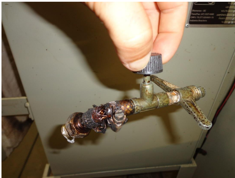
Figura 7.1 – Mangueira de gás perfurada devido à alta temperatura do biogás no ponto de coleta
