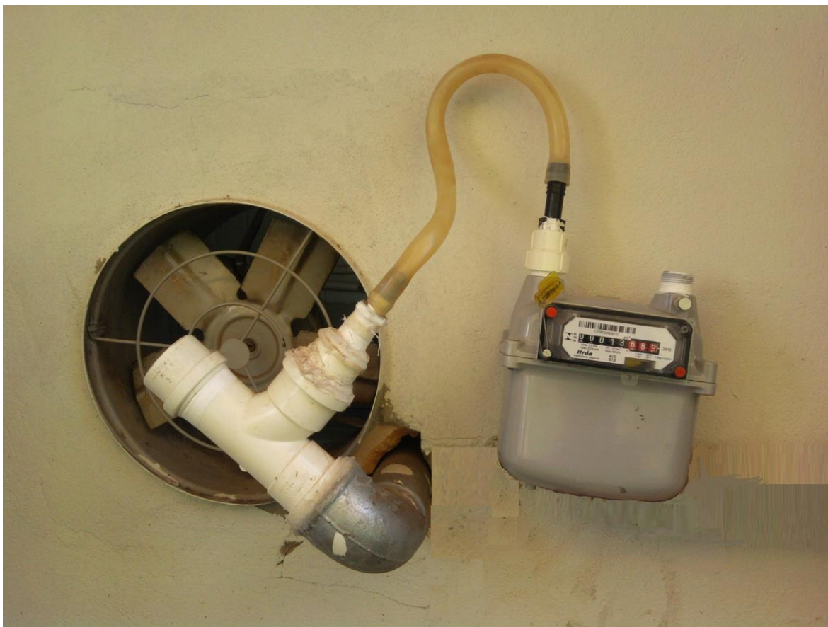
Figura 3.10 – Gasômetro ao final do sistema de exaustão dos gases
