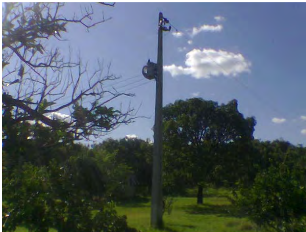
Figura 27 – Transformador monofásico de distribuição rural.
