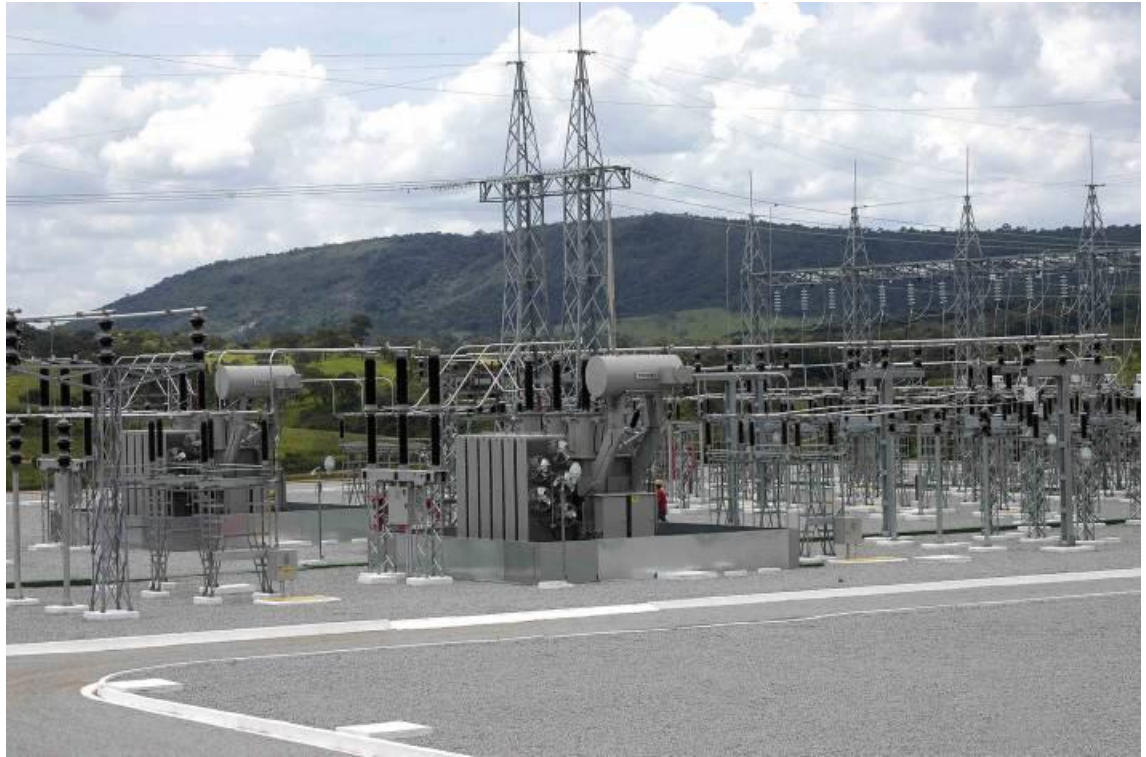
Figura 2 - Subestação elevadora de Juiz de Fora (MG) extraído de http://www.pracomprar.com/v2/abrir/site/blp-engenharia/servicos/1420
