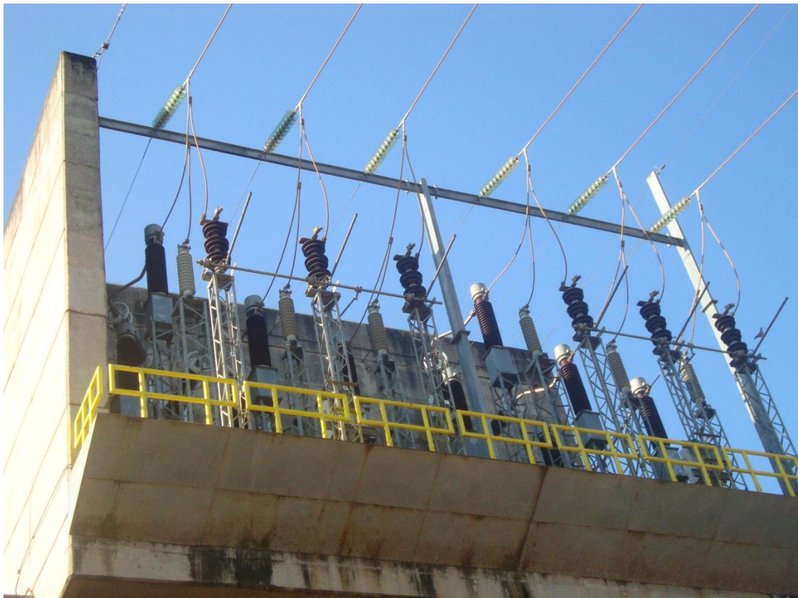
Figura 3 - Subestação elétrica da usina de Igarapava - SP
