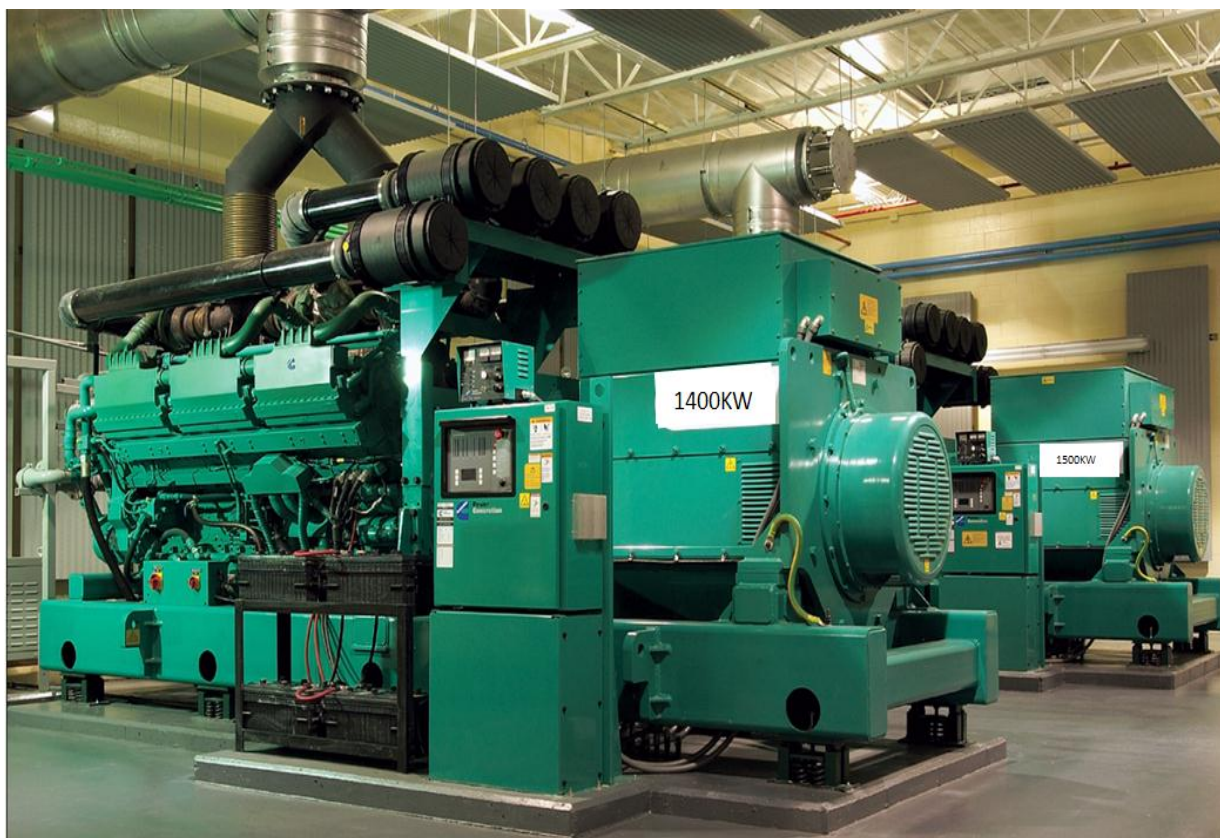
Figura 1.4 – Usina Geradora de 2,9MW, gás+diesel, projetada pelo autor, em instalação em “edifício inteligente” para trabalho em paralelismo permanente com a rede (Peak shave).
