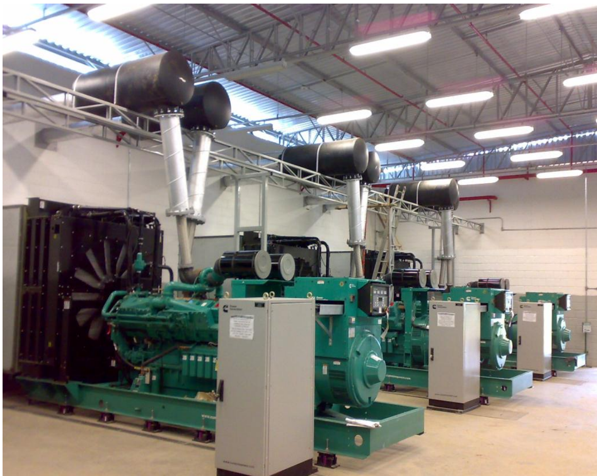
Figura 1.2 - Usina Geradora de 7,5MVA projetada e instalada e comissionada pelo autor na Motorola em Jaraguaina-SP-BR.
