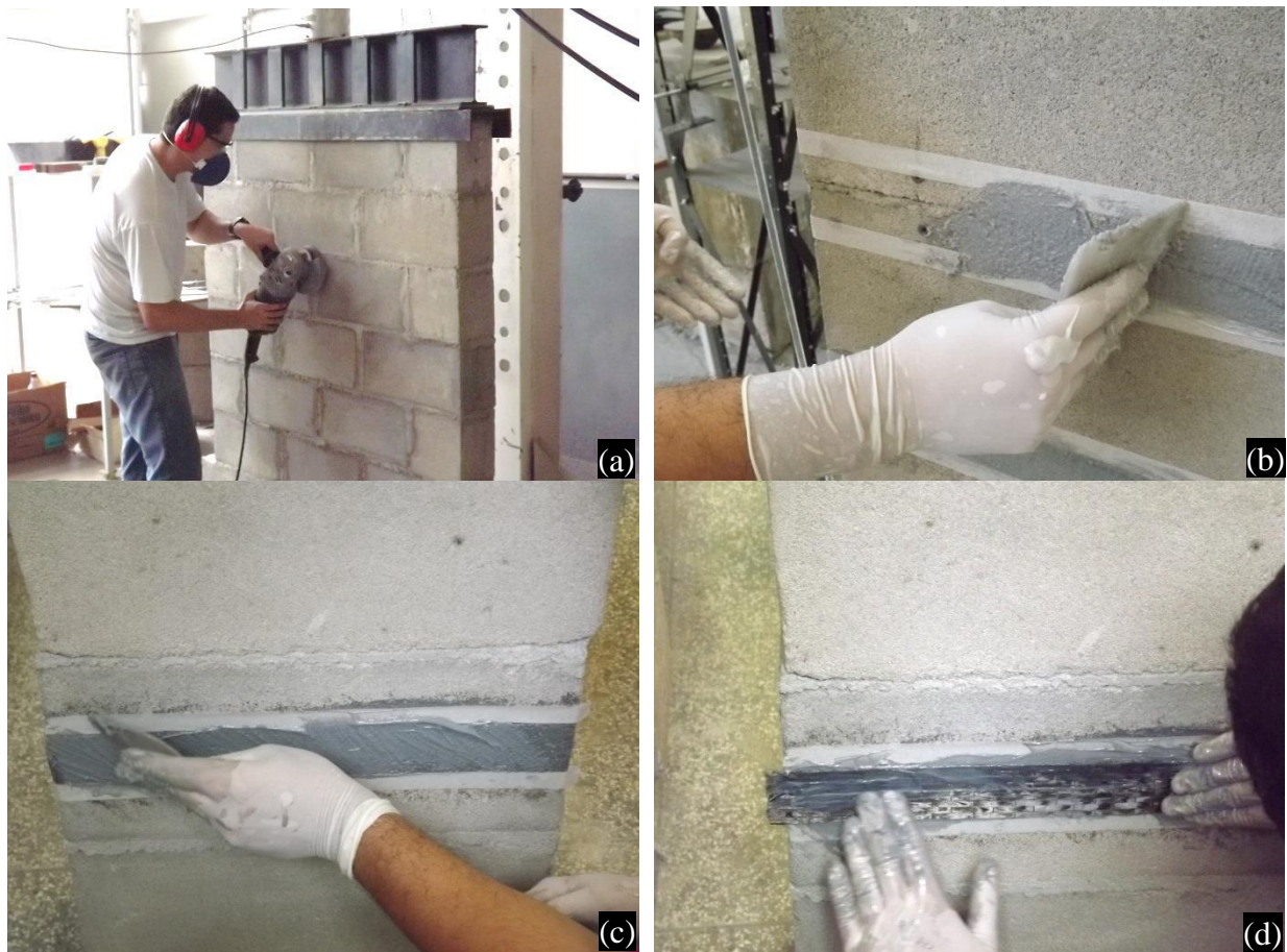
Figura 4.13 – (a) Paineis sendo lixados; (b) Preparação da base com resina epóxi e carga quartzosa, área delimitada; (c) Aplicação da resina epóxi de impregnação; (d) Posicionamento da faixa de fibra de carbono.
