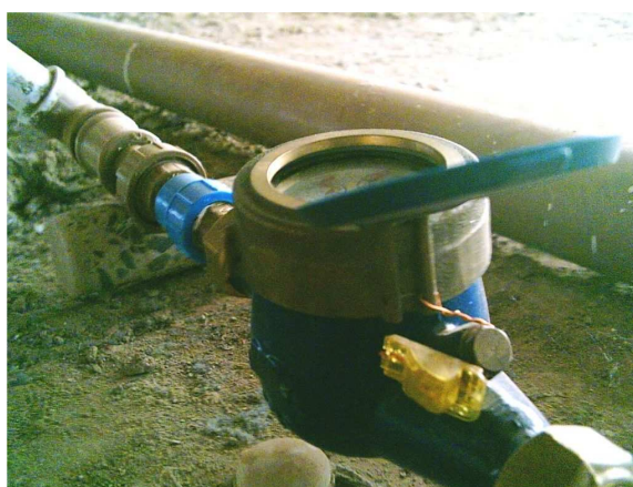
Figura 46: Hidrômetro instalado no Bloco 50A Fonte: Arquivo pessoal do autor
