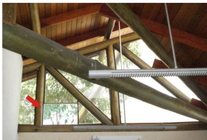
Figura 118 – Movimentação da estrutura provocou trincas no vidro que foi repostado
