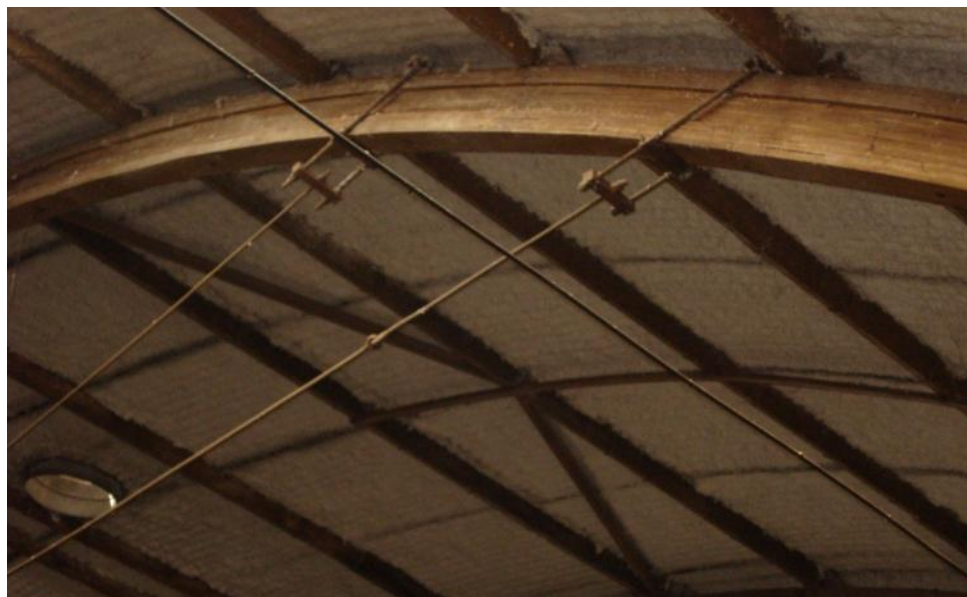
Figura 97 – Abraçadeiras para fixação dos tirantes
