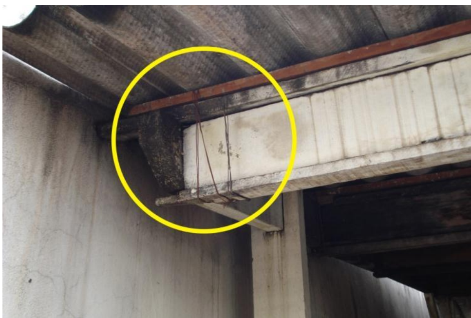
Figura 63 – Suposto reforço de partes da viga com arame
