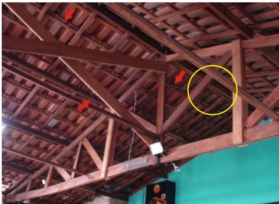
Figura 45 – Contraventamento adicional para estabilização global da estrutura e detalhe da ligação da diagonal com banzo inferior
