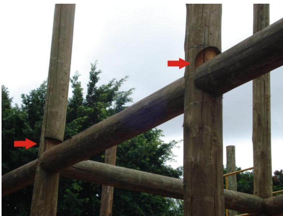
Figura 101 – Encaixe incorreto da madeira
