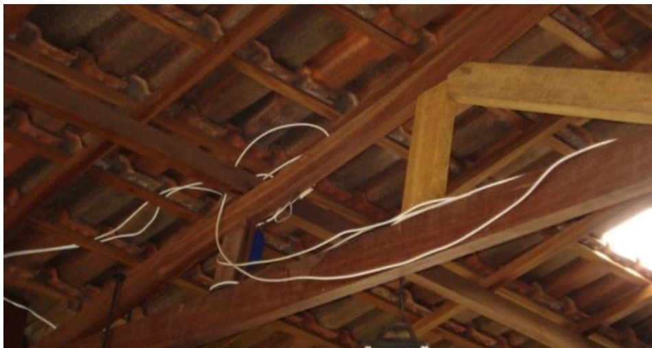
Figura 44 – Ligações inadequadas entre montantes, diagonais e banzos
