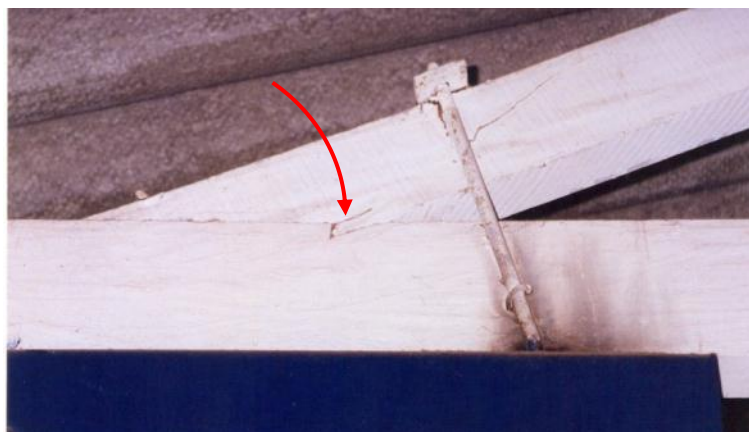
Figura 74 – Patologia clássica em nó entre banzo inferior e superior
