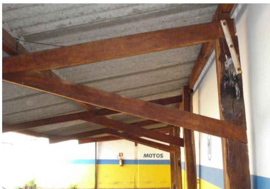
Figura 68 – Presença de agentes patológicos e reforço inadequado em ligação viga-pilar
