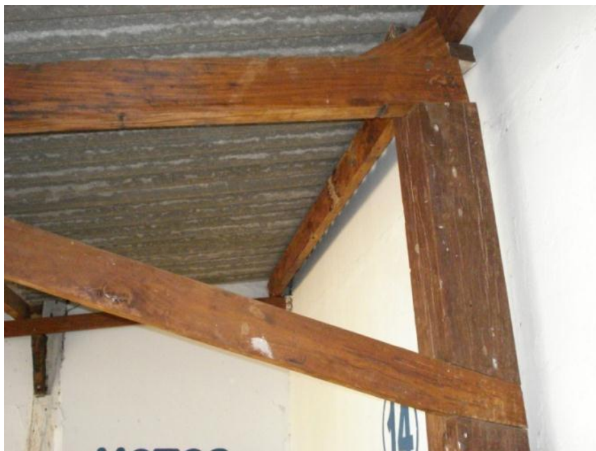
Figura 67 – Entalhe desnecessário de parte importante da seção transversal do pilar para ligação
