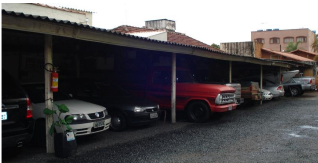
Figura 61 – Situação atual das vigas apresentando deformações excessivas
