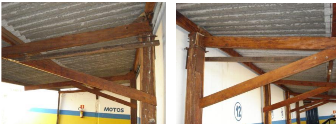
Figura 69 – Reforço inadequado de madeira e chapas de aço amarradas
