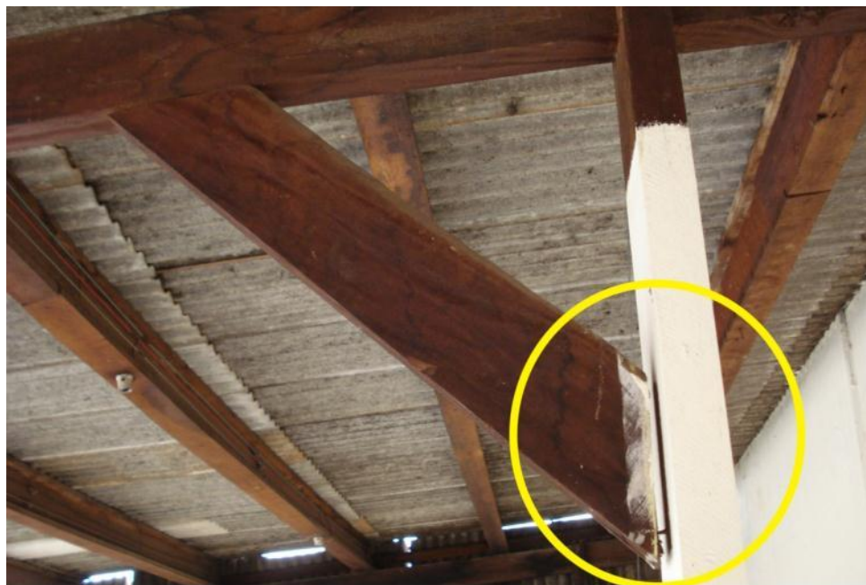
Figura 62 – Folga na ligação de partes da estrutura
