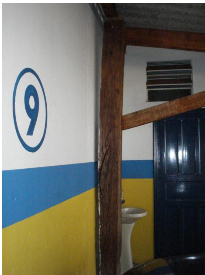
Figura 70 – Deformações e fissuras em pilar
