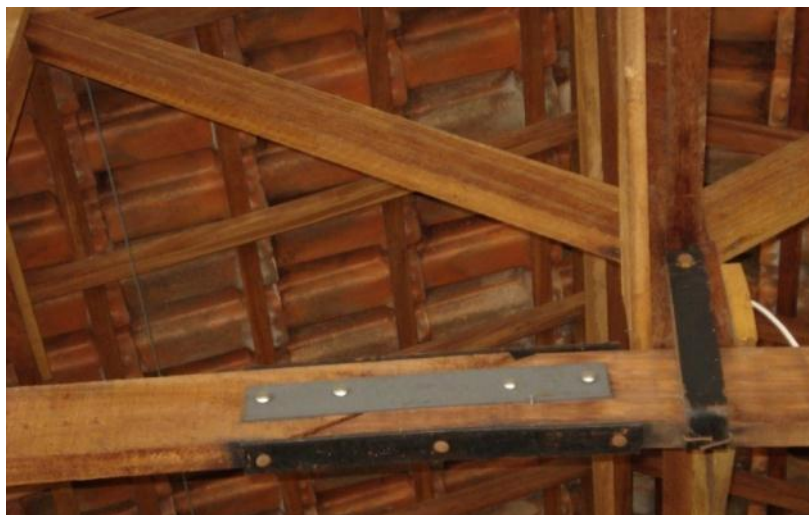
Figura 48 – Ligação de peças com chapas: espaçamento grande entre as peças devido à tração
